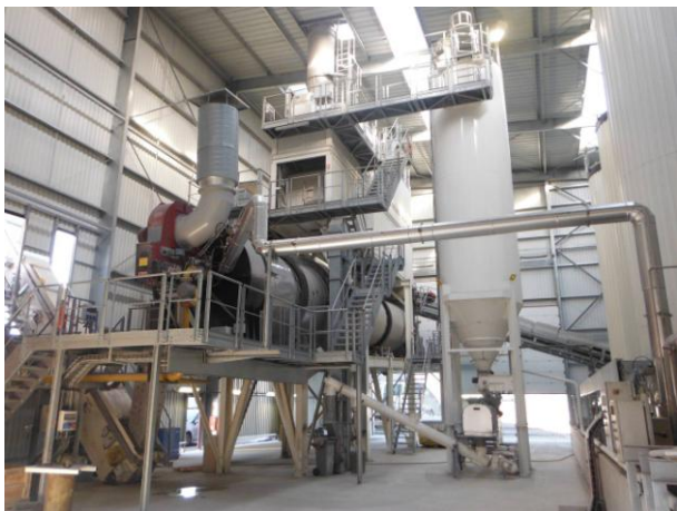
RF Néo asphalt plant
